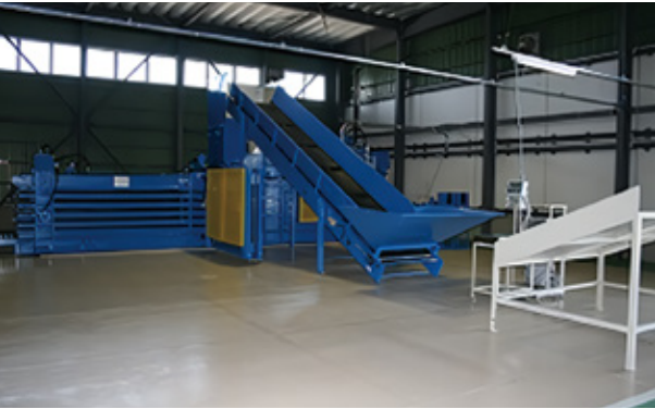
▲廃ダンボール圧縮設備
