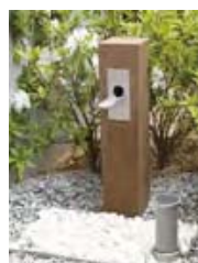
雨水利用システム
