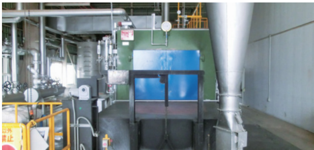
沼田工場のバイオマスボイラー
