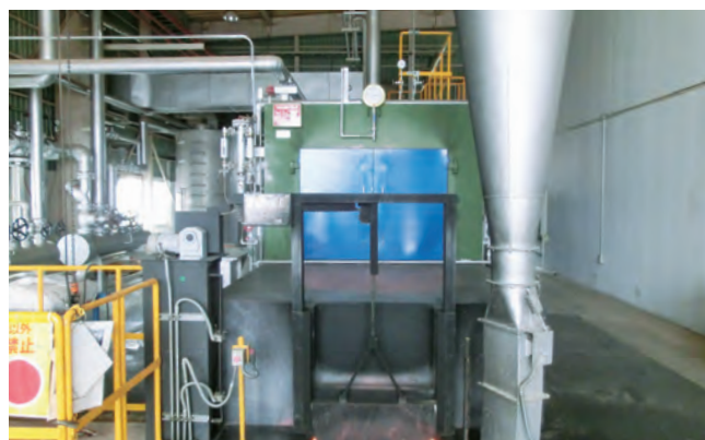
沼田工場のバイオマスボイラー
