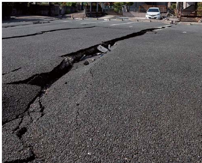
熊本地震の特徴であった地割れ被害
