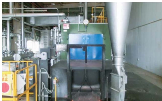
沼田工場のバイオマスボイラー
